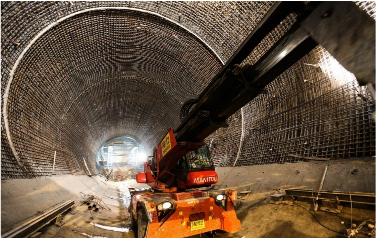
TÚNEL EM CARGA - conclusão da montagem de armadura / preparação para montagem de cimbre
