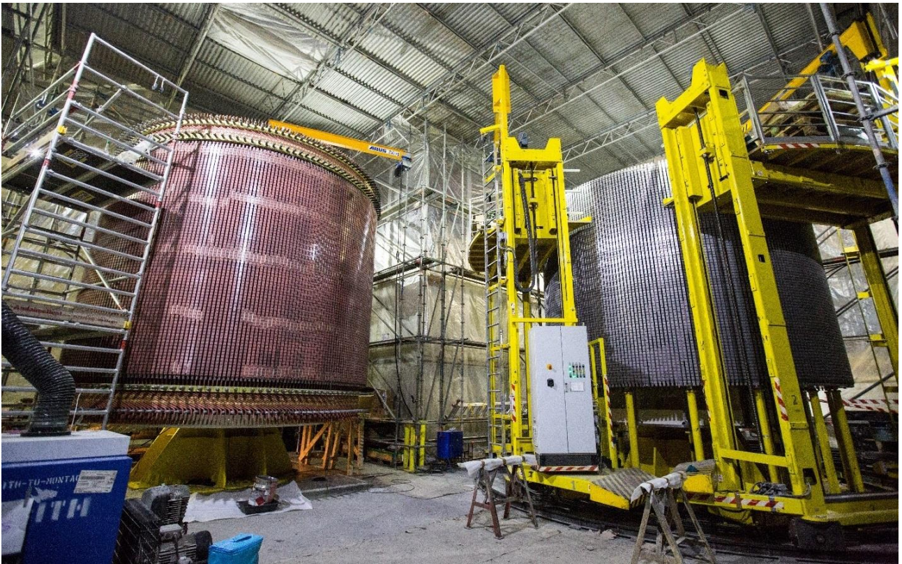
CENTRAL – empilhamento dos rotores dos Grupos
